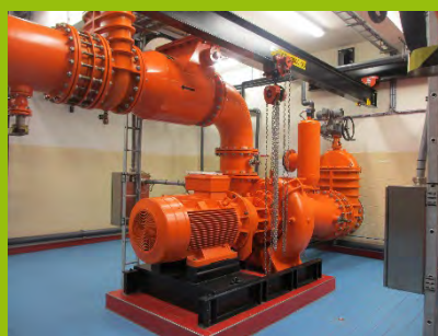
Rioolgemaal ( Westersingel, Rotterdam)
